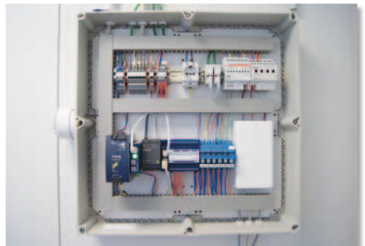
Hier laufen alle Fäden zusammen: der Schaltschrank in der Tennishalle. (Bild PCI Services)
